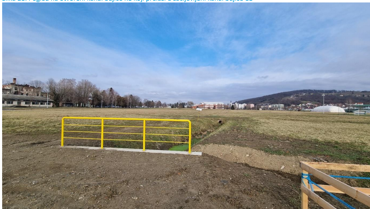
Slika 21: Pogled na otvoreni kanal bujice K1 koji prelazi u zacijevljeni kanal bujice C1
